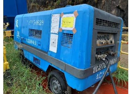
使用獲環保署核准的流動發電機 (非道路移動機械)
